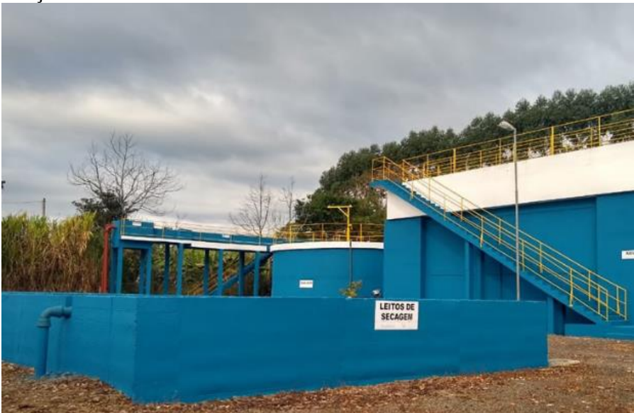
Figura 23 - Estação de tratamento do SAMAE no bairro 1º de maio em Praia Grande
