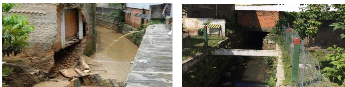
Figura 6.3 - Construções rentes às margens do rio Criciúma; figura 6.4 - construção sobre o rio
