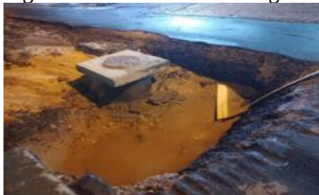
Figura 6.8 : Cratera na rua Engenheiro Jorge Becker, bairro Próspera
