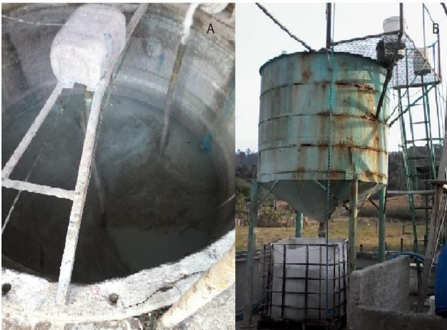
Figura 8– Tanque de equalização (A) e floculador/decantador (B).
