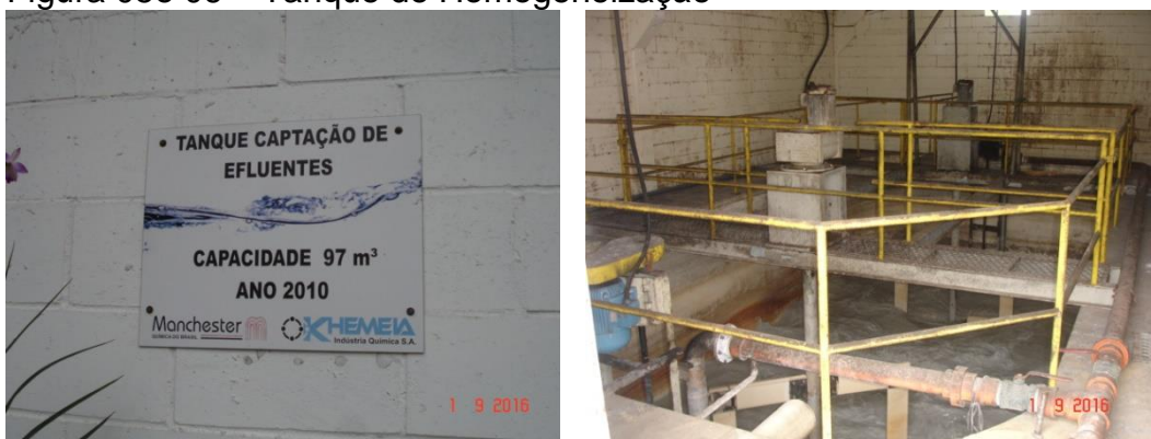
Figura 05e 06 – Tanque de Homogeneização
