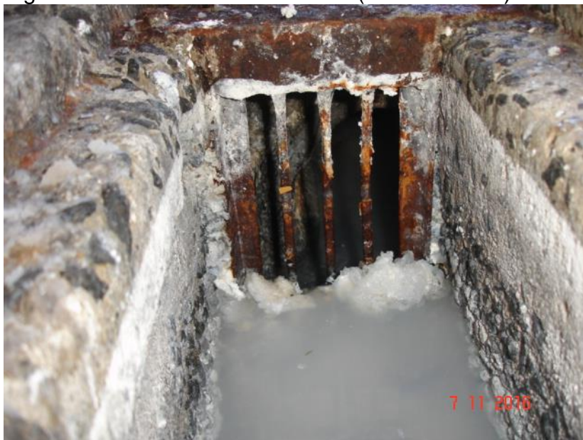
Figura 04 – Tratamento Preliminar (Gradeamento).
