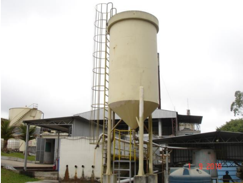
Figura 07 – Silo de Armazenamento de Lodo.
