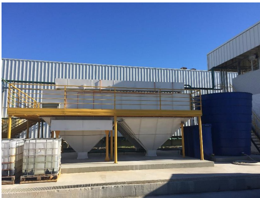
Figura 2 – Estação de tratamento de efluentes Empresa 2.
