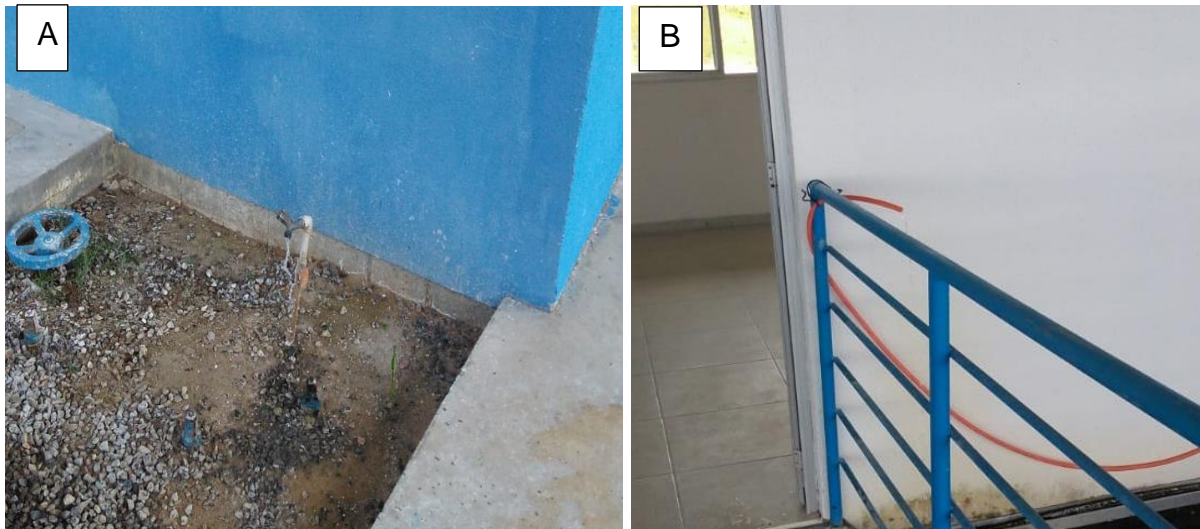
Figura 5 – Pontos de coleta de água bruta (A) e tratada (B) da ETA II.
