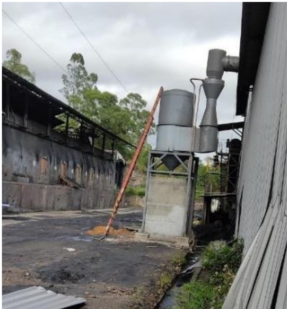
Figura 24: Lavador de gases do tipo Venturi.
