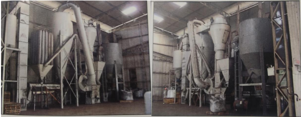
Figura 07: Equipamentos do sistema de captação de pó e silos da produção de Cardiff.
