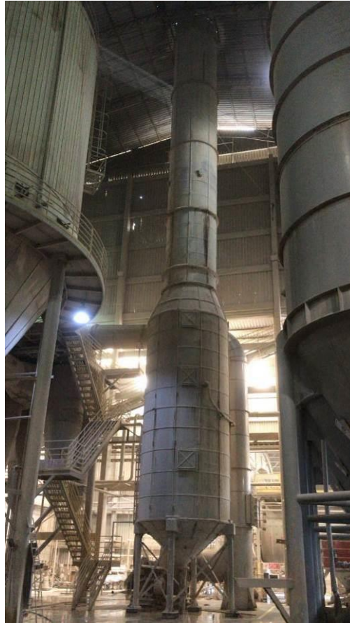
Figura 5 – Lavador de gases.
