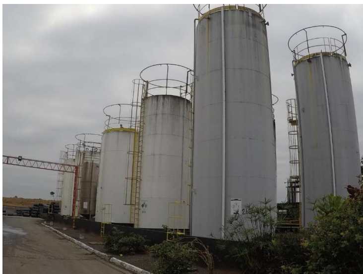
Figura 10 - Tanques de armazenamento
