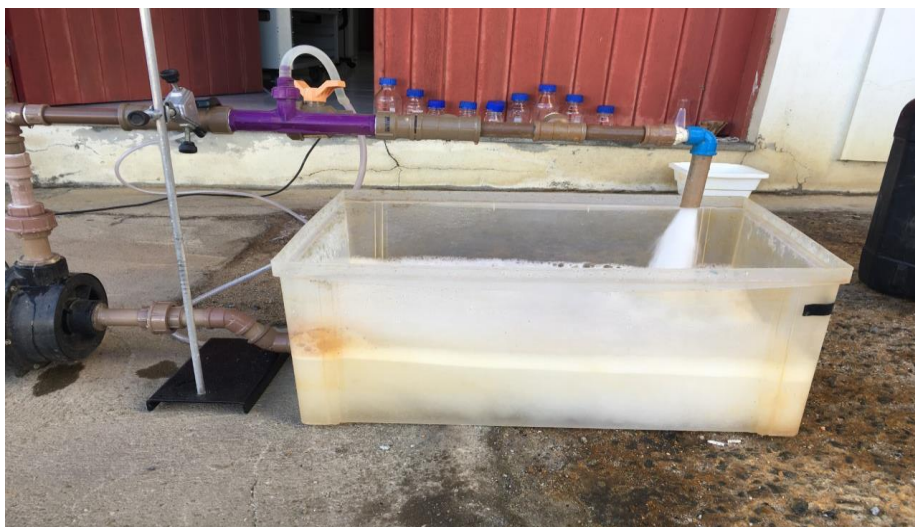
Figura 14 – Sistema de Oxidação Com Ozônio.
