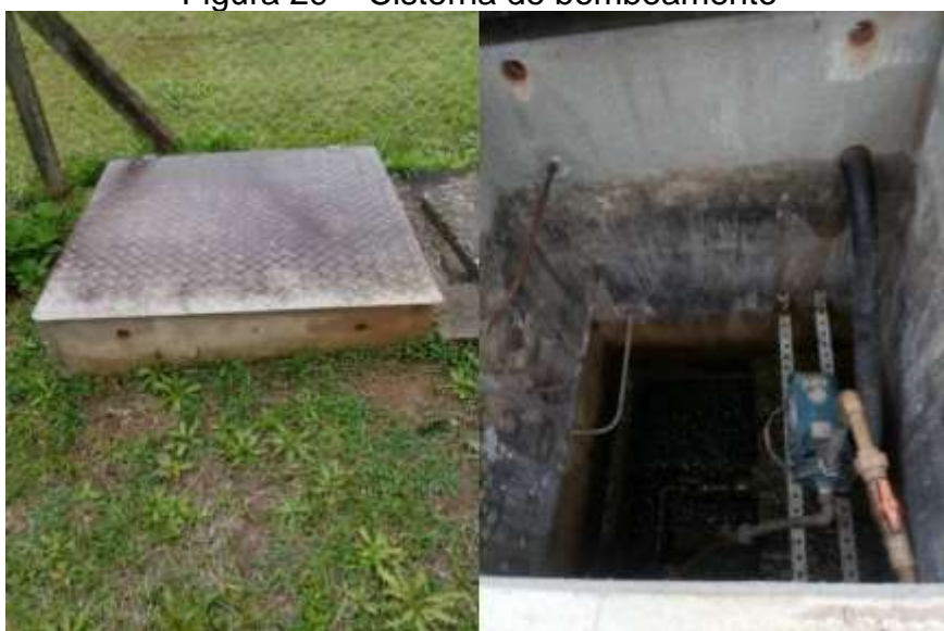
Figura 29 – Cisterna de bombeamento
