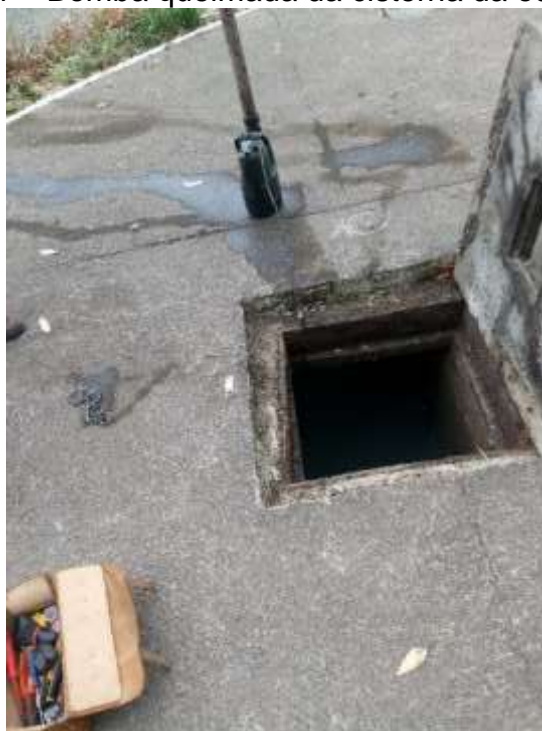
Figura 31 – Bomba queimada da cisterna da odontologia
