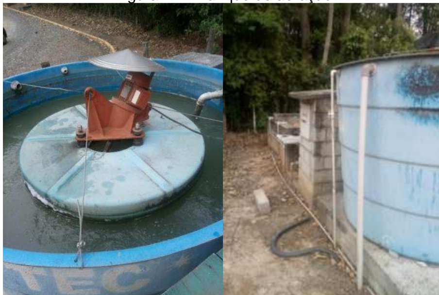
Figura 21 – Tanque de aeração
