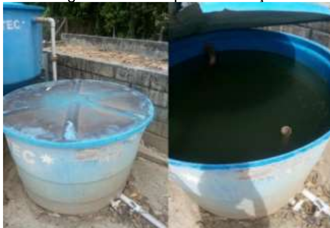
Figura 25 – Tanque de cloração
