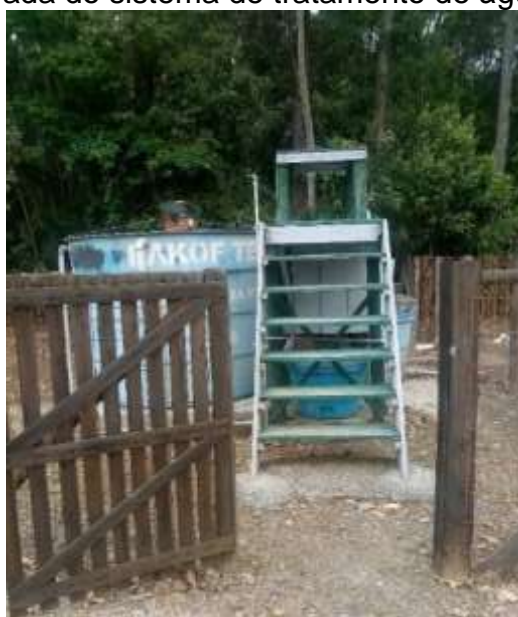
Figura 20 – Entrada do sistema de tratamento de águas residuárias 1
