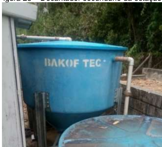
Figura 23 – Decantador secundário da estação 1
