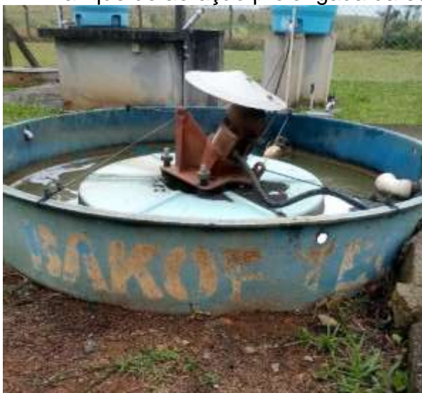
Figura 27 – Tanque de aeração prolongada da estação 2
