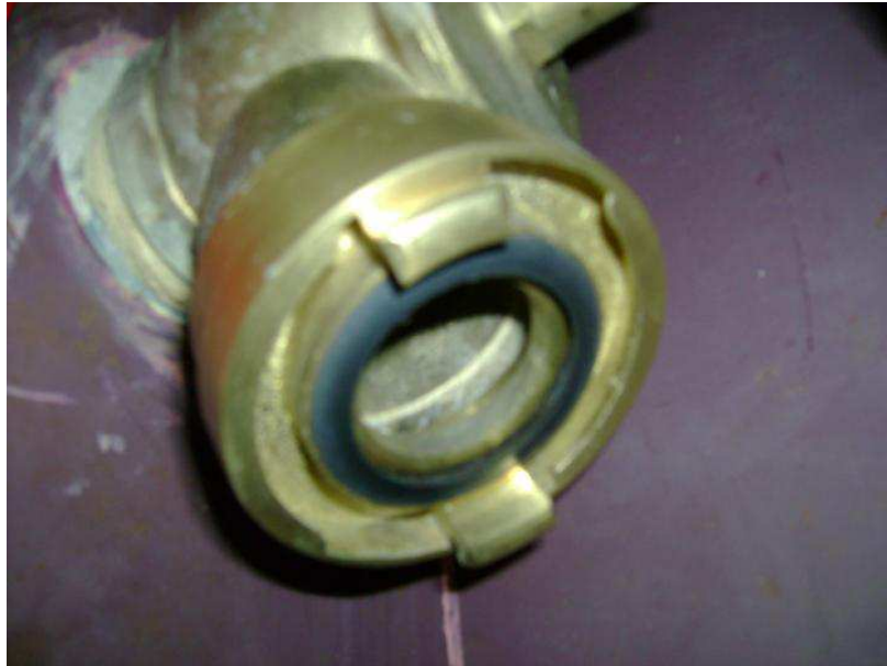
Figura 6 – Hidrante de parede – adaptador Fonte: Zanin (2008)
