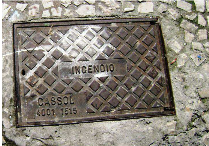
Figura 12 – Hidrante de recalque Fonte: Zanin (2008)
