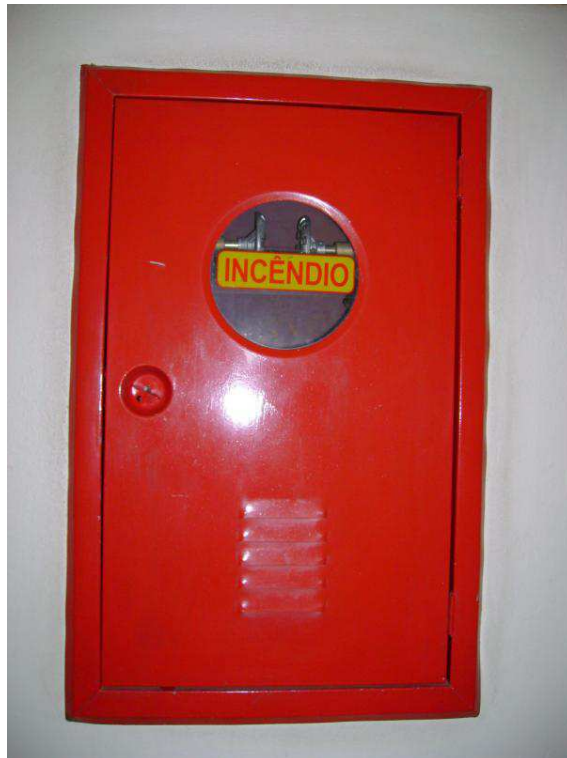
Figura 7 – Hidrante de parede – Abrigo Fonte: Zanin (2008)
