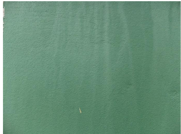
Fig. 11 - Manchamento em parede da cor Verde Quadra com a água da ETA
