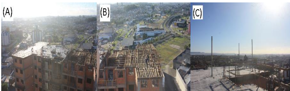
Figura 8: (A) Concretagem da laje; (B) Escoramento da forma; (C) Linha de vida
