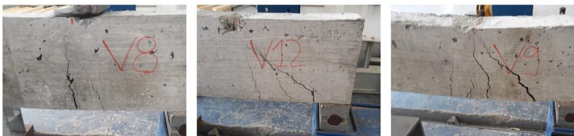
Figura 16 - Fissuras Vigas Maciças com S cada 16 cm
