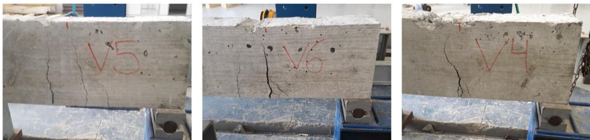
Figura 18 - Fissuras Vigas Maciças com S a cada 10 cm
