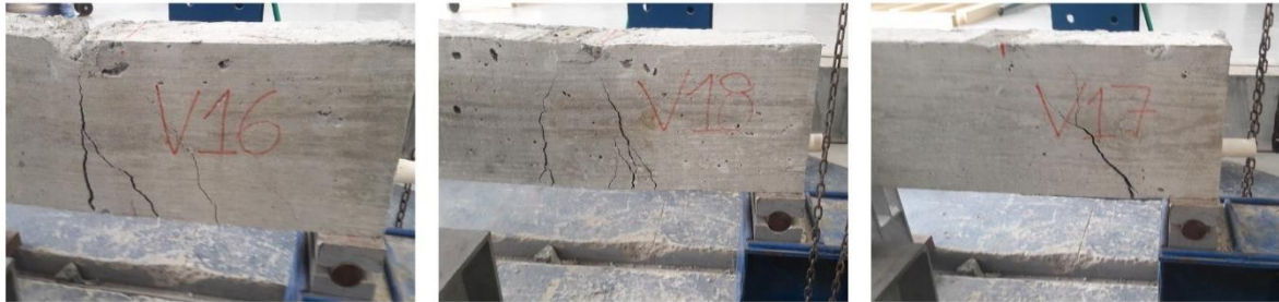
Figura 17 - Fissuras Vigas Ocas com S a cada 10 cm
