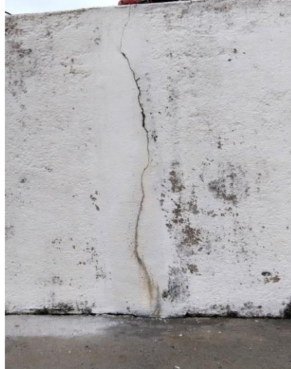
Figura 1 – Fissura escolhida para receber o tratamento de reparo.
