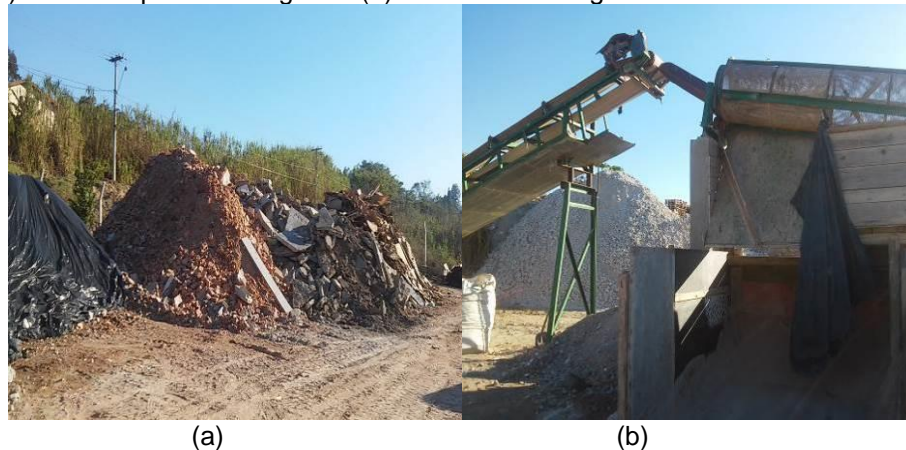
Figura 4 – (a) Materiais para reciclagem e (b) Usina de reciclagem 3R's.
