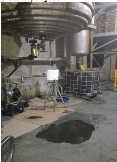
Figura 30: Água derramada no chão da fábrica simulando produto perigoso.
