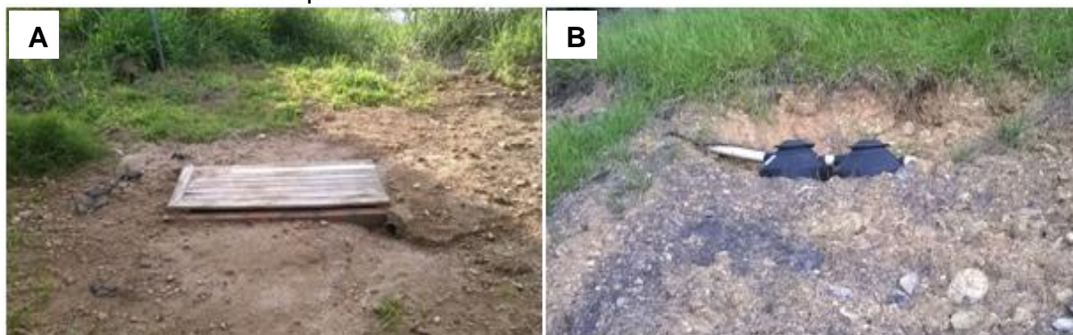
Figura 6: Fossas sépticas instaladas na empresa. A - Fossa séptica instalada nos escritórios. B - Fossa séptica instalada no Beneficiamento.
