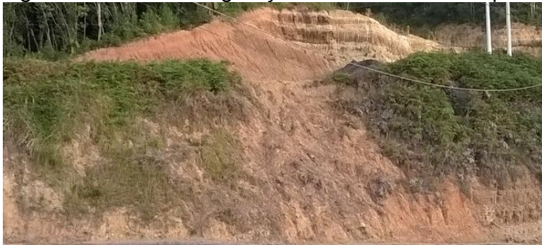
Figura 13: Falta de vegetação nos taludes da empresa.
