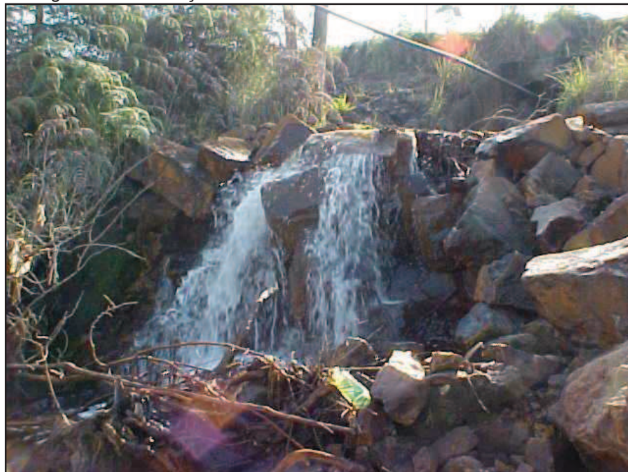
Figura 27 – Drenagem de contribuição no Trecho 8.
