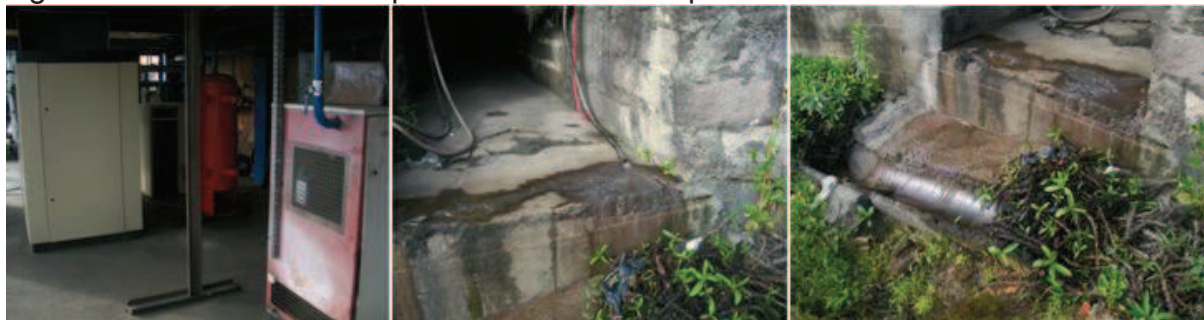
Figura 28 - Arraste de óleo proveniente dos compressores
