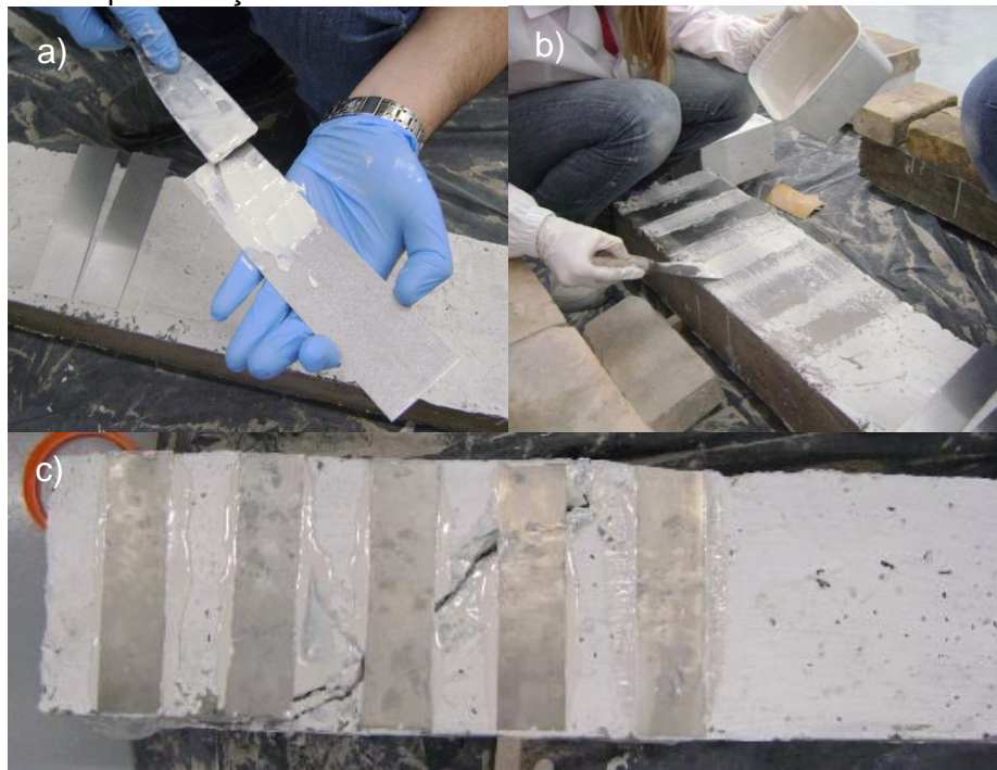
Figura 6: a) Aplicação do adesivo estrutural na chapa de aço SAE 1020, com espessura de 0,75 mm. b) Aplicação do adesivo estrutural na viga de concreto armado. c) Viga após a aplicação das chapas de aço.
