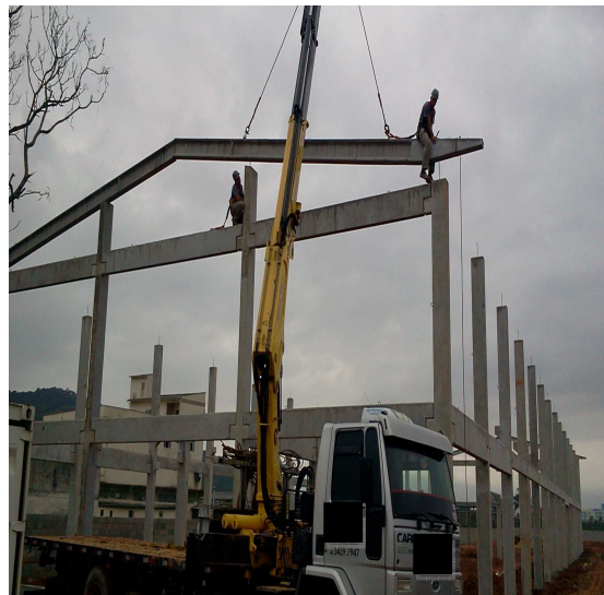
Figura 03: Posicionamento operários incorreto e cintos de segurança engatados na peça içada.
