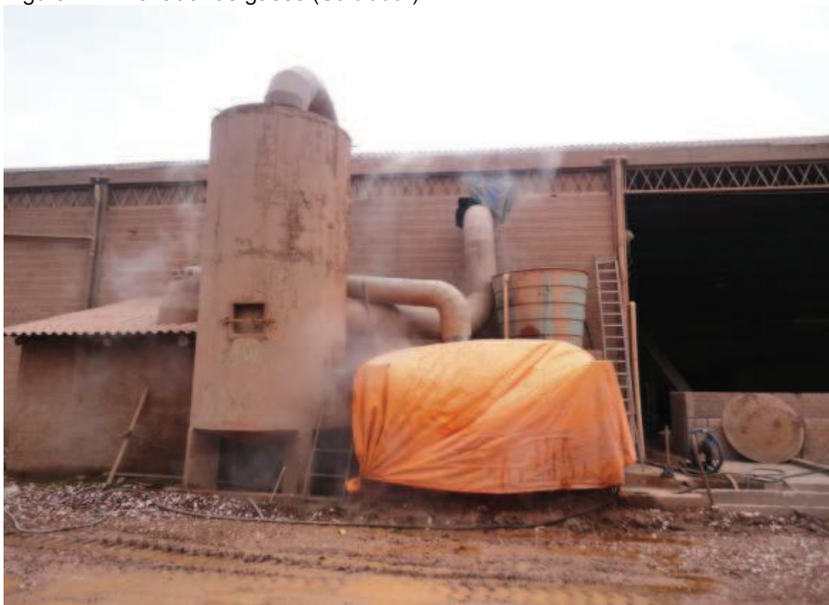
Figura 17 – Lavador de gases ( Scrubber )
