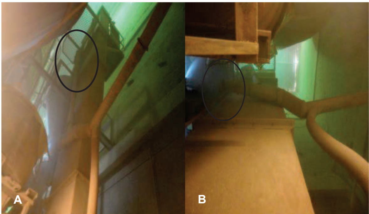
Figura 29 – A – Tubulações sem captores; B – Tubulação não conectada
