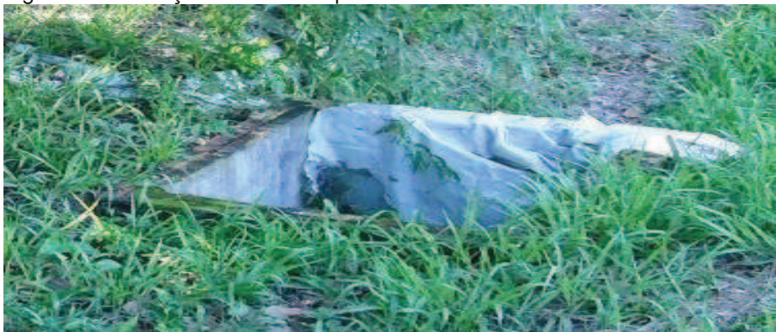
Figura 09 – Situação da manta impermeabilizante
