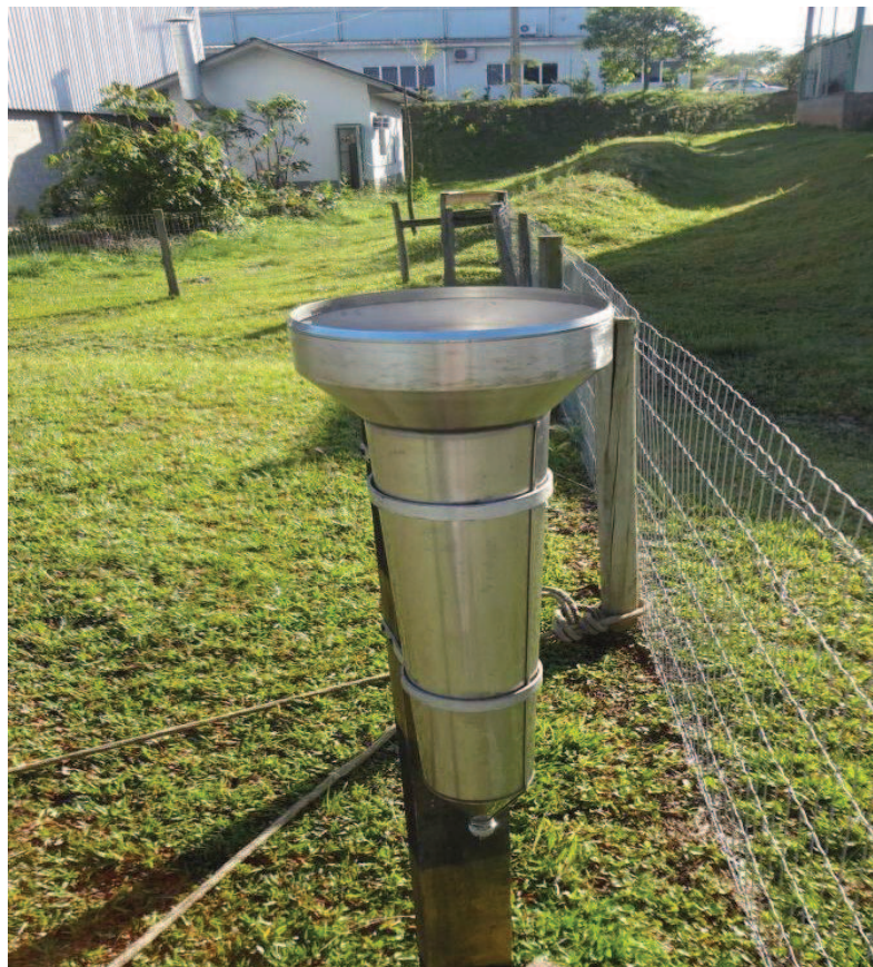
Figura 12 - Pluviômetro instalado na unidade.
