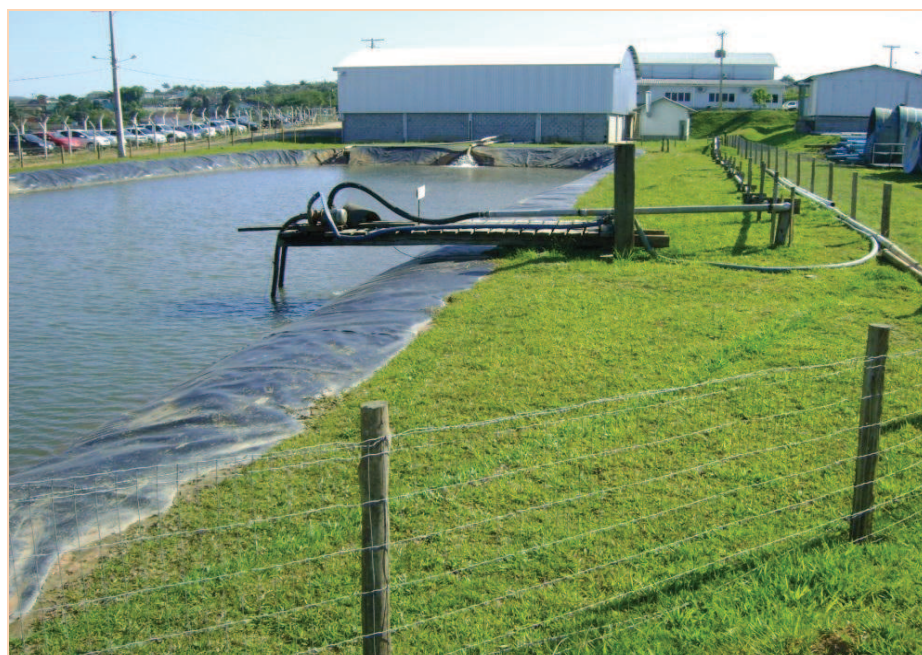
Figura 51 - Bacia de sedimentação de efluente tratado.
