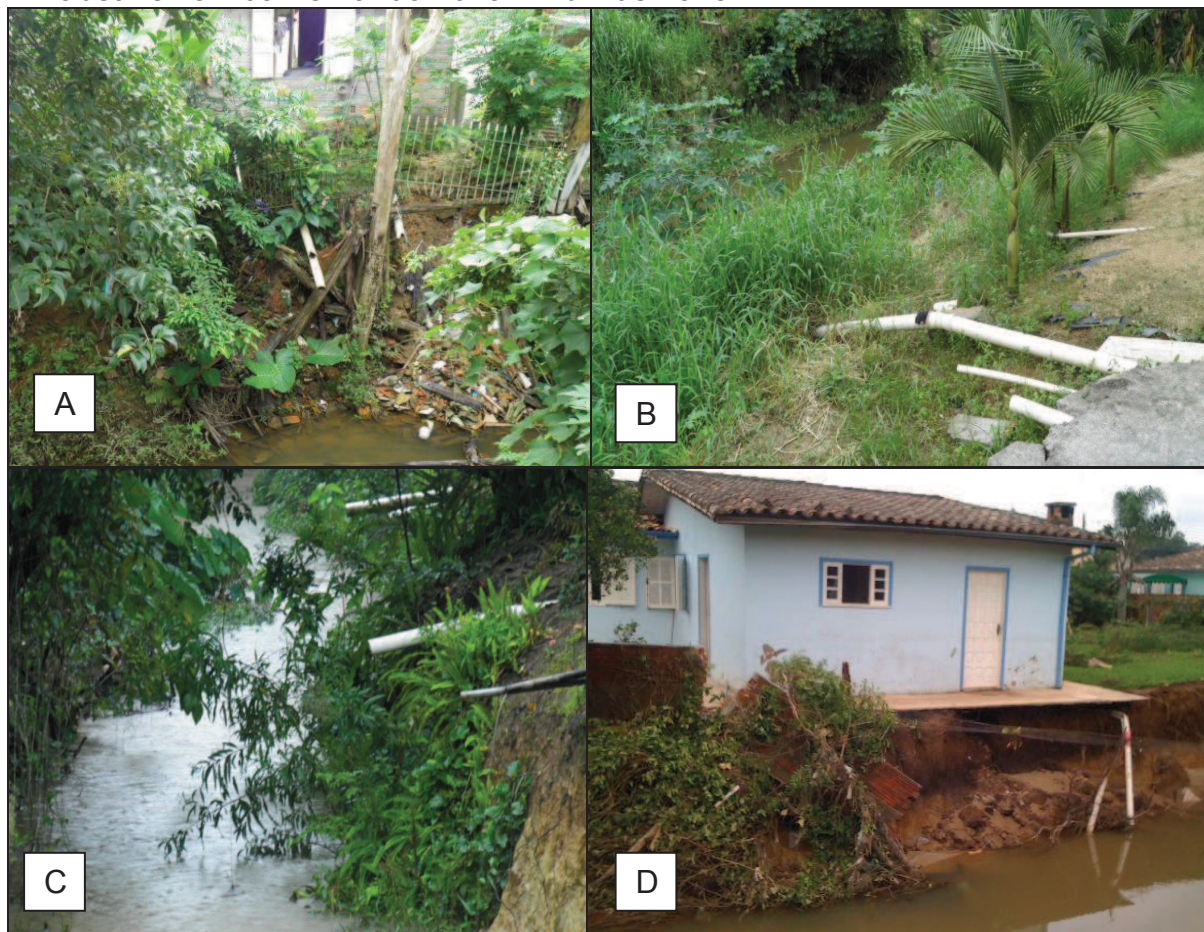
Figura 04 – A) Esgoto a céu aberto no setor 29, no Bairro Jardim Elizabeth e na Rua Umuarama. B) Esgoto a céu aberto no setor 03, no Bairro Brasília e na Rua Hernesto Bettiol. C) Esgoto a céu aberto no setor 29, no Bairro Jardim Elizabeth e na Rua Fernando Furlan. D) Esgoto a céu aberto no setor 29, no Bairro Jardim Elizabeth e na Rua Fernando Furlan. Abril de 2013.
