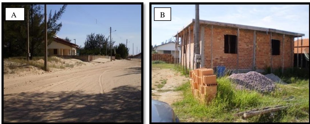
Figura 3 - A) Casas com arruamento não pavimentado em área de dunas; B) Casa em construção.
