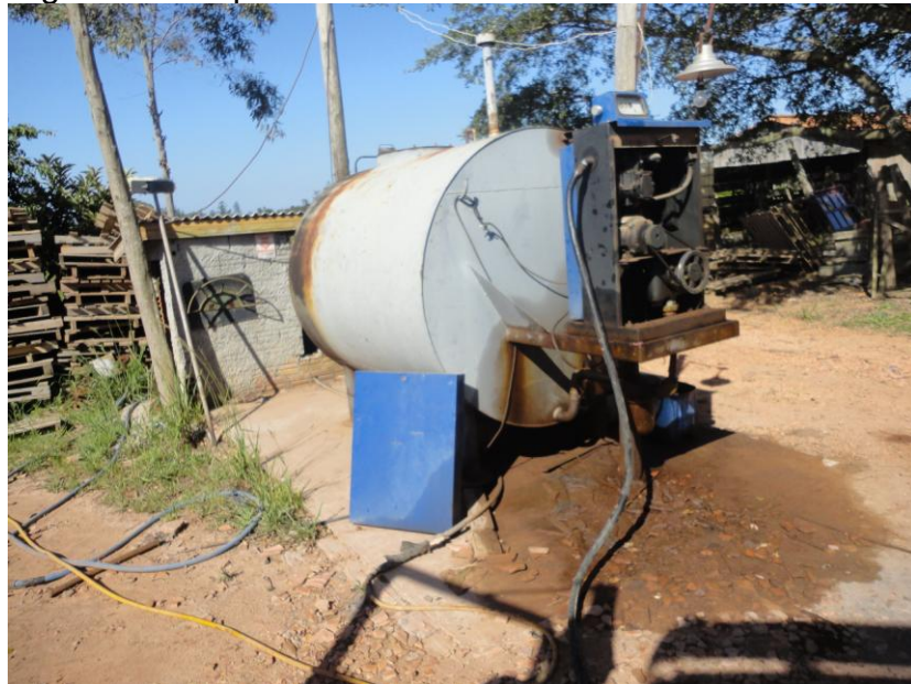
Figura 7: Tanque de armazenamento de combustível
