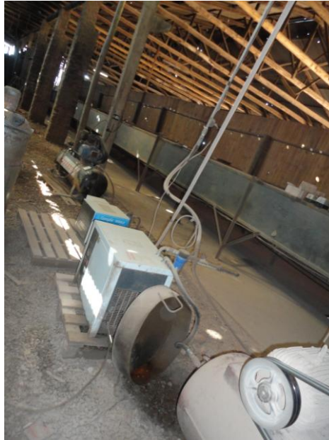
Figura 10: Compressor de Ar
