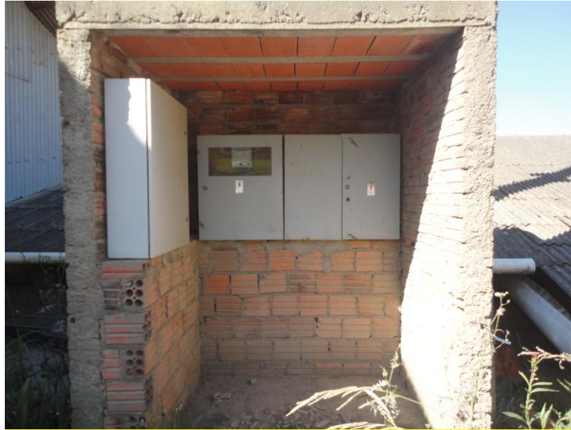
Figura 8: Painel de Comando elétrico
