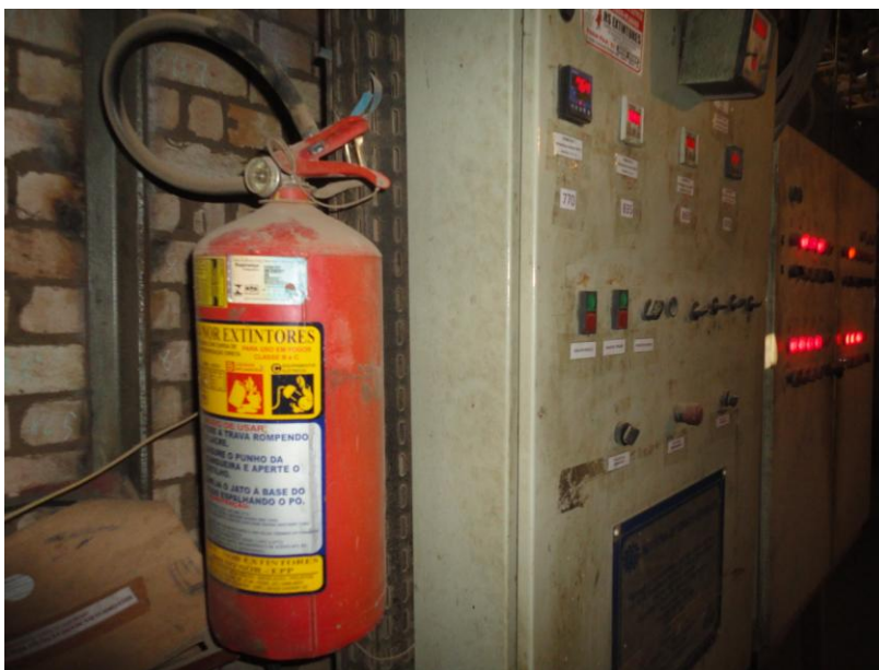
Figura 6: Extintor de incêndio ao lado do painel de comando
