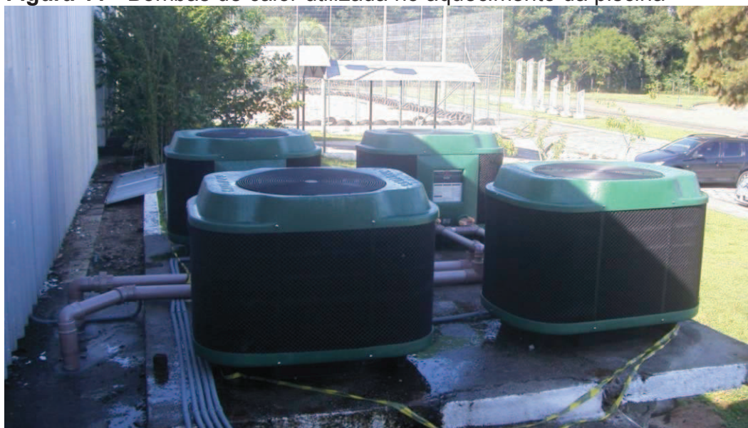
Figura 11 - Bombas de calor utilizada no aquecimento da piscina
