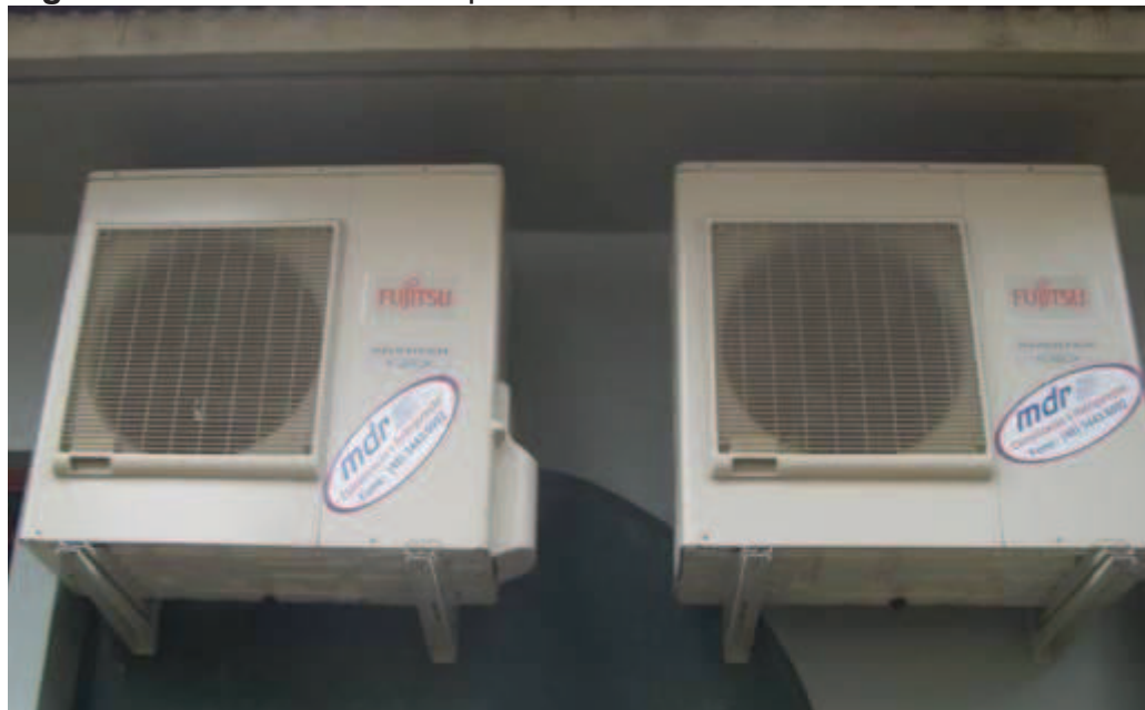
Figura 29 - Climatizadores Split Inverter
