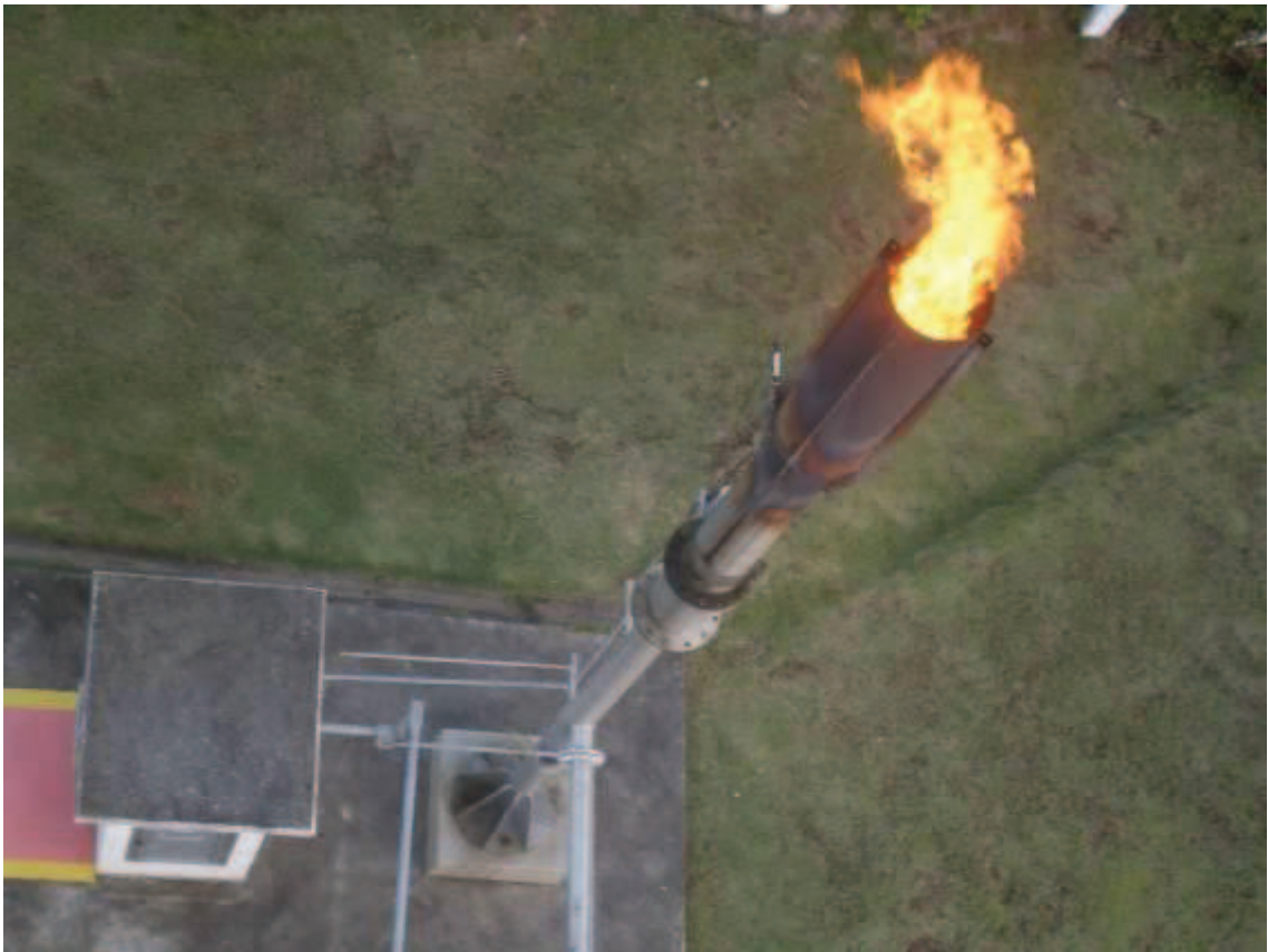
Figura 19 – Queima de gás no flaire proveniente do reator anaeróbio.
