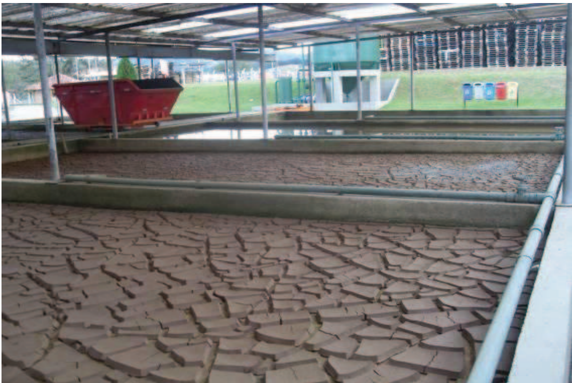
Figura 18 – Leito de secagem do lodo proveniente da ETE.
