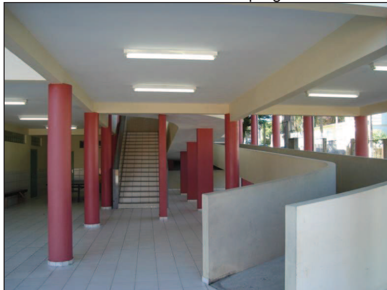
Figura 41: Local onde será instalada a fotocélula programável
