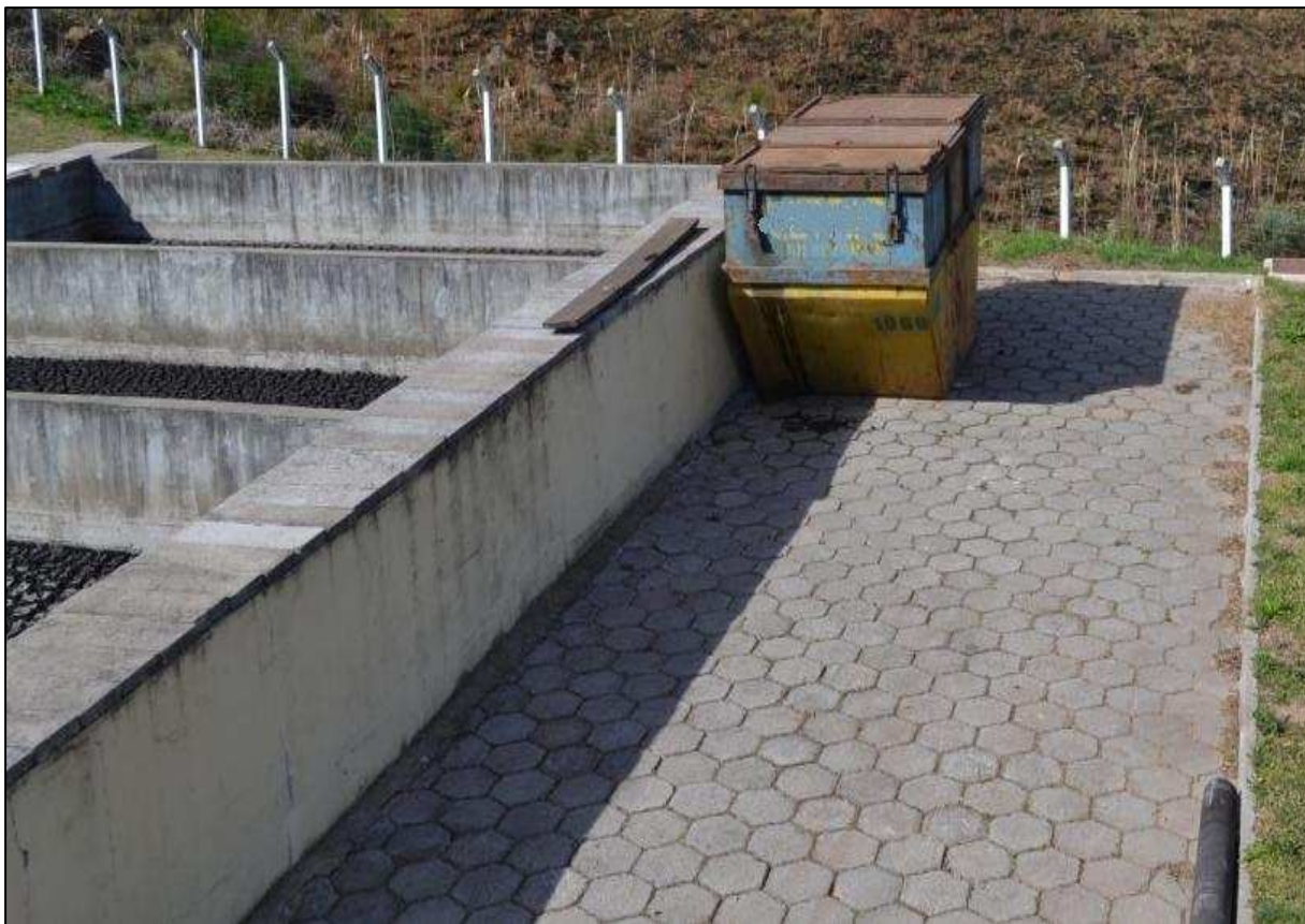
Figura 5 – Diferença de nível entre leitos de secagem e caçamba
