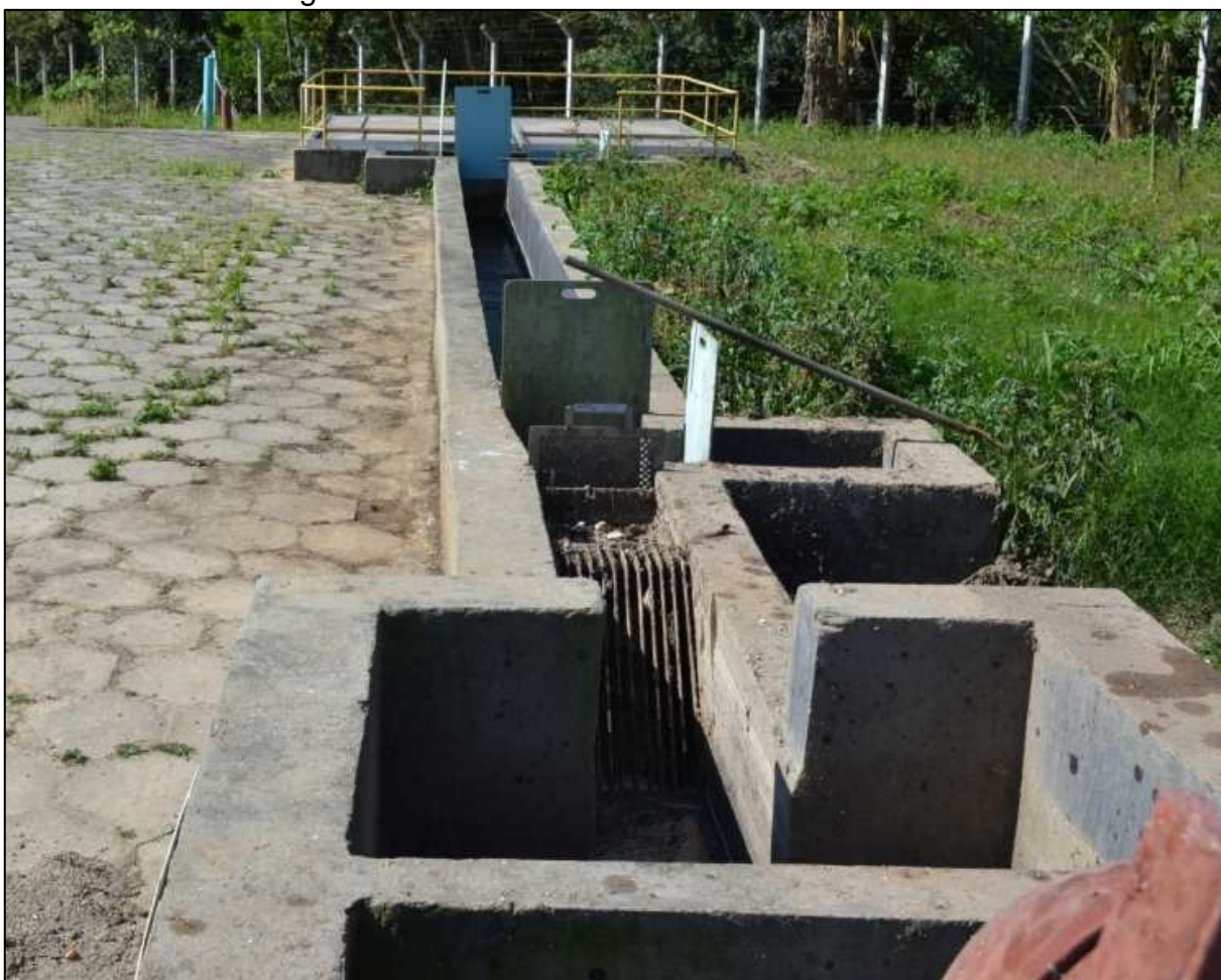
Figura 1 – Canal do Gradeamento ETE Gravatal
