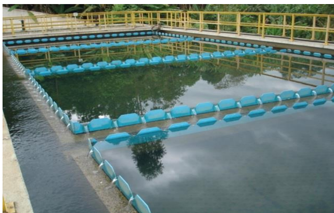
Figura 2 - Decantadores da ETA de Criciúma
