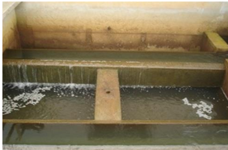
Figura 3 - Filtros da ETA de Criciúma
