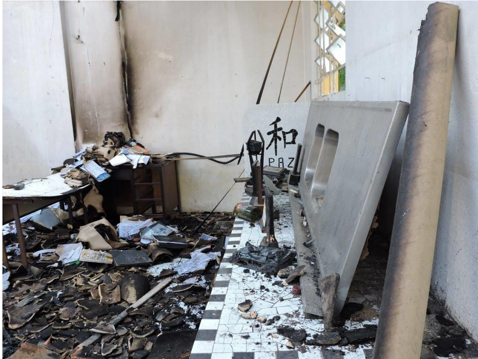
Imagem 10 – Centro Cultural Jorge Zanatta após abandono e incêndio em setembro de 2017
